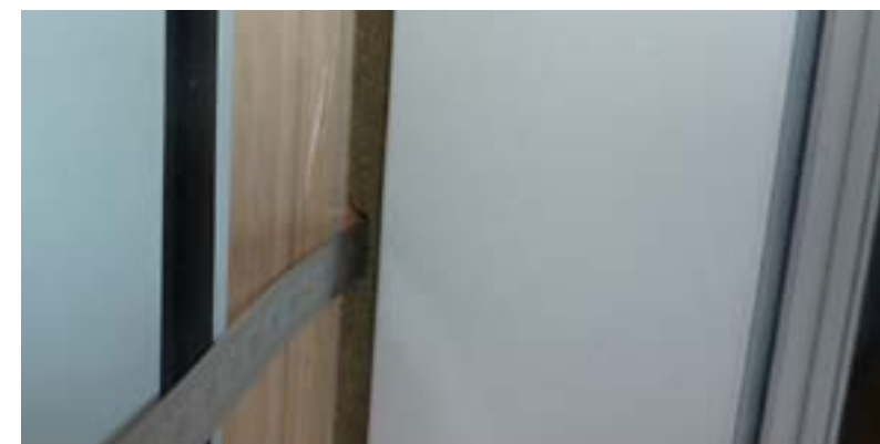
Mousse imprégnée insuffisamment comprimée (Crédit photo: Saretec)
